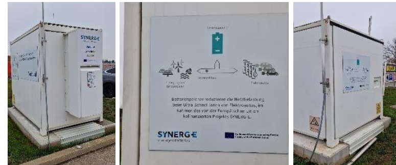
Batteriespeicher Wr. Neustadt
